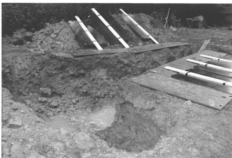
Obrázek 6, Přítomnost vody ve výkopu [5]
