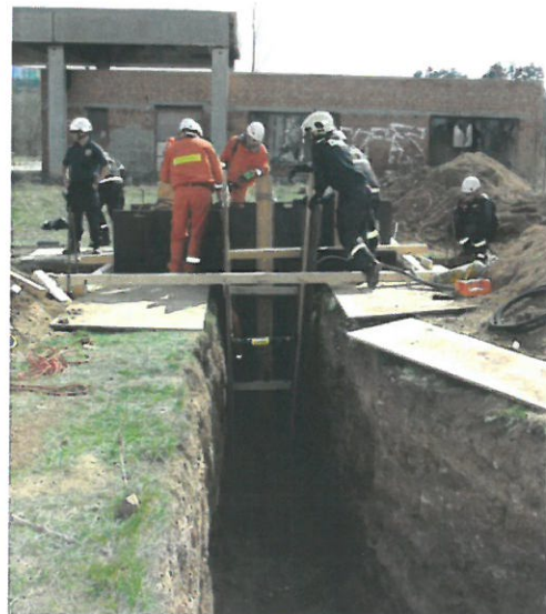
Obrázek 131, Ukázka možnosti doplnění utrženého vnitřního rohu pomocí nízkotlakých vaků a celkové pohledy na situaci [5]
